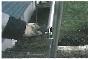
Sett i rekkverklåser.
